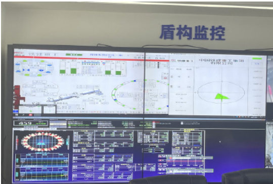
盾构机监控中心
