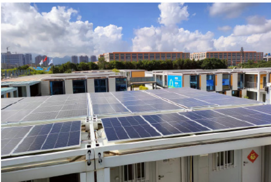
太阳能光伏板
