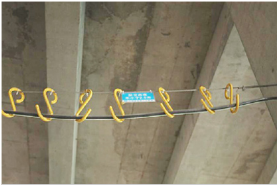
电缆悬空架设
