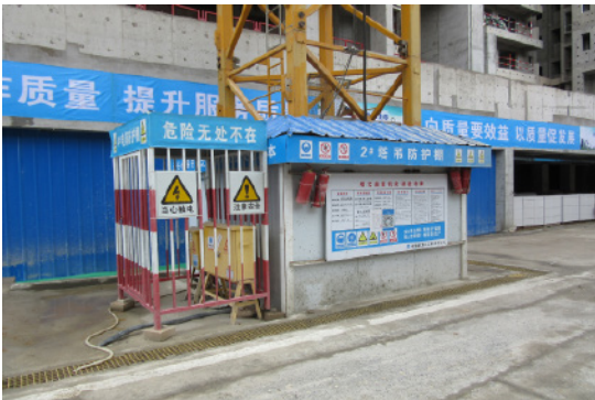
塔吊首层防护
