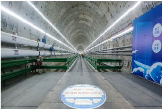
隧道灯带照明
