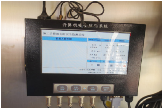
安全监控系统
