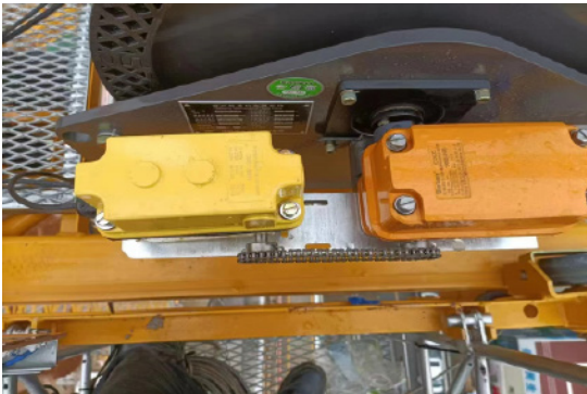
塔吊限位装置
