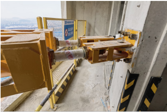
塔吊附墙装置
