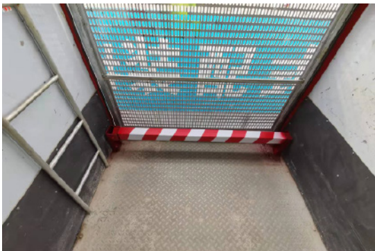
梯笼内机械止档装置
